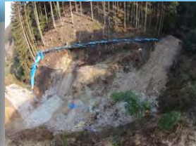
危険な災害現場
